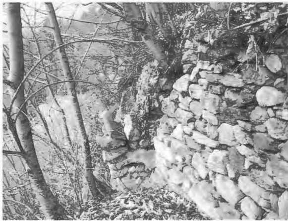
Fig. 6. Spanciamento del muro di sostegno dovuto a spinta idrostatica. Fonte: fotografia di T. Pagnoncelli.
